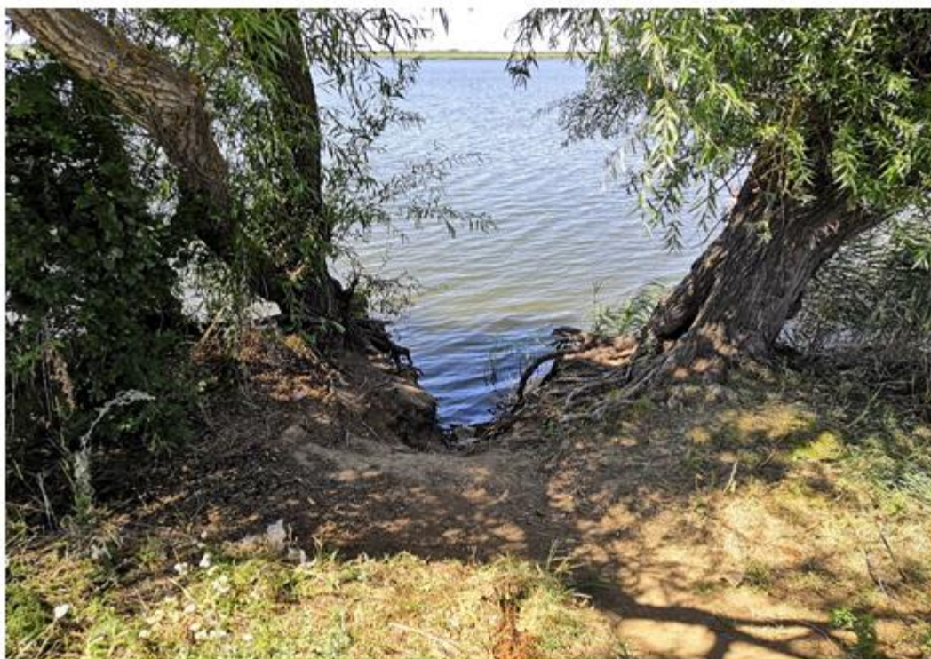
Рисунок 1 – Подмыв верхового откоса плотины Ахмато-Лавровского водохранилища
